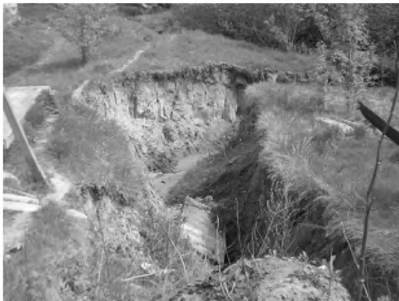
Рис. 1. Размыв в районе городской подстанции
