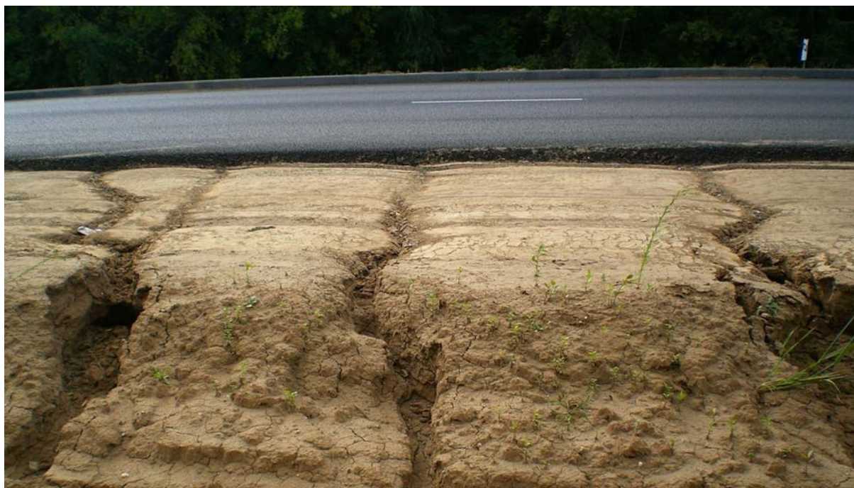
Рис. 2. Эрозионно-денудационный рельеф на неукрепленных откосах земляного полотна Fig. 2. Erosion and denudation relief on unfortified slopes of road embankment
