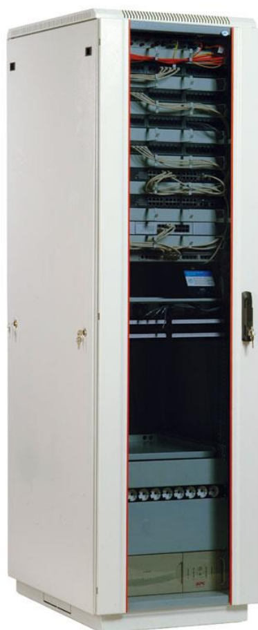
Рисунок 3.5– Телекоммуникационный шкаф ЦМО ШТК-М-42.6.10-3AAA
