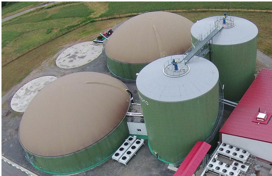
Рис.1.2.5. Газгольдеры биогазовой станции «Лучки», Белгородская область
