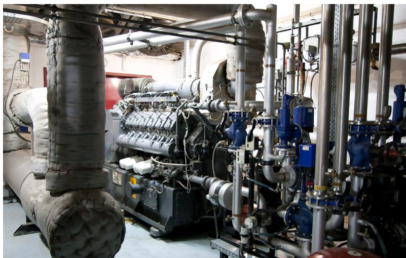
Рис. 1.2.8. Генератор электрической энергии биогазовой станции «Лучки», Белгородская область (67)
