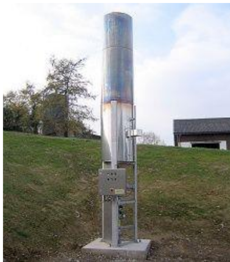
Рис. 1.2.7. Вид факельной установки биогазовой станции (68)
