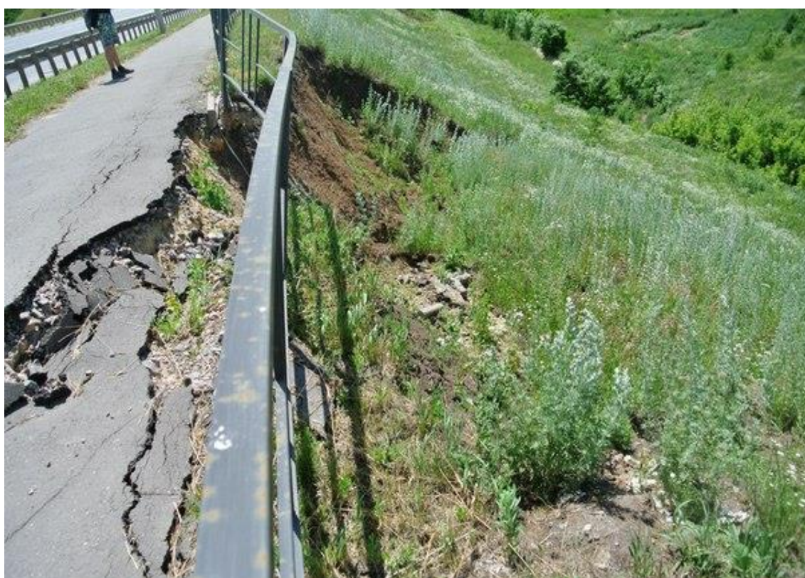
Рис. 3.18. Интенсивное оврагообразование тротуара Восточной объездной дороги (фото автора)
